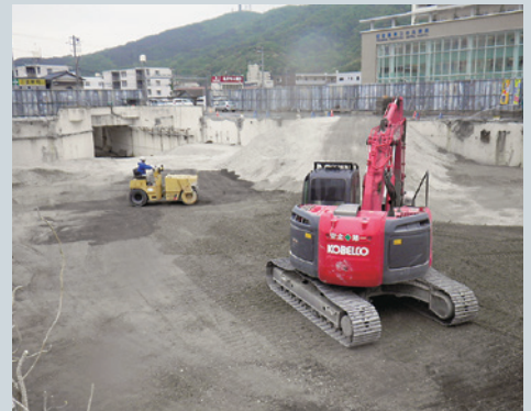
徳島県発注：中央病院旧本館棟解体工事にて埋戻し材として利用
